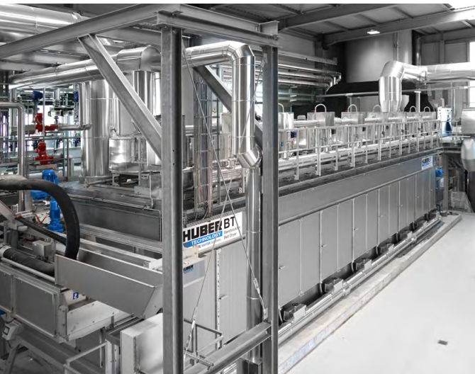
Der HUBER Bandtrockner BT trocknet Klärschlamm auf über 90 % Trockenrückstand.
